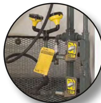
Vue de la section de pulvérisation
